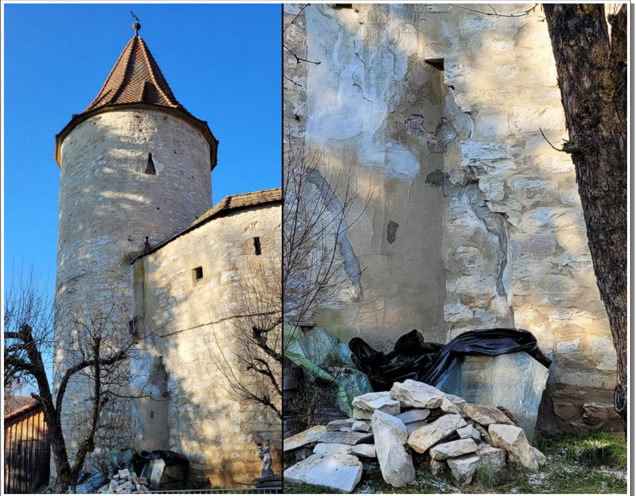
Der wichtige Badturm von außen, im Januar 2024 - aus der Sicht des Gartens der Familie Hofbauer. Die vermauerte Juden-Pforte von einst ist wegen der Einziehung gut sichtbar, der ausgebrochene Bogen harret der Instandsetzung.
